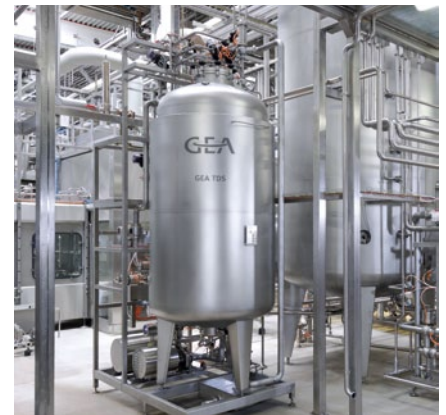
Anlage zur Karbonisierung
