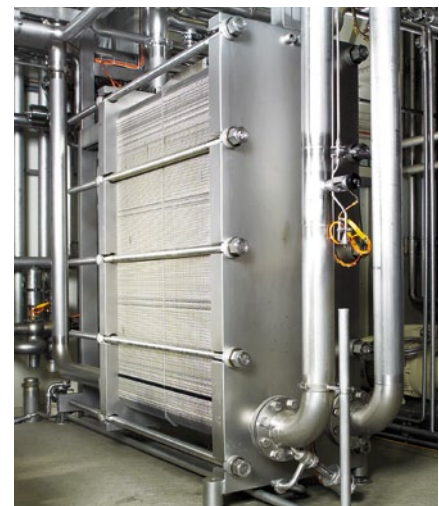
Plattenwärmetauscher mit einer Leistung von 50.000 l/h
